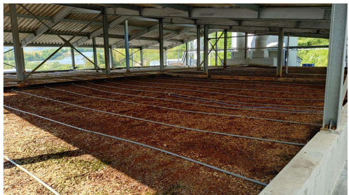
バイオフィルター上部の木質チップ（下からの臭気がろ過される）
