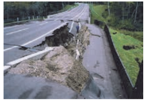
写真 1-11 多くの道路が損壊した 24 線砂川橋
