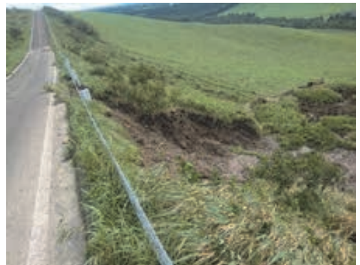
写真 1-7 崩落した路肩 開陽台展望台入口
