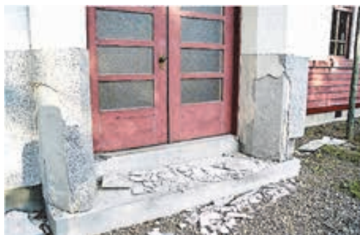
写真 1-12 玄関付近の壁崩落状況
