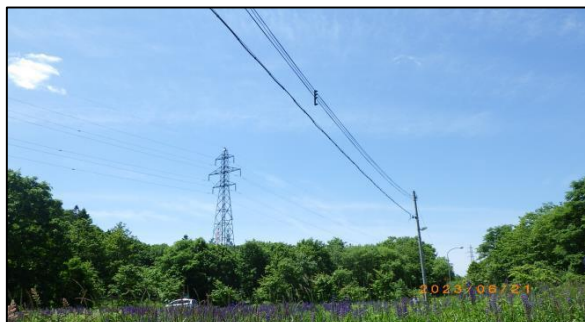
架空線、高圧送電線（写真奥側）
