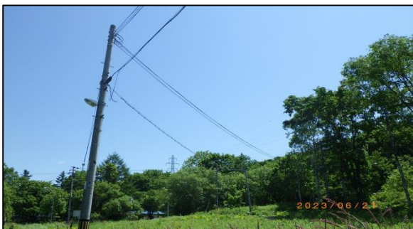
電柱、電話柱、架空線
