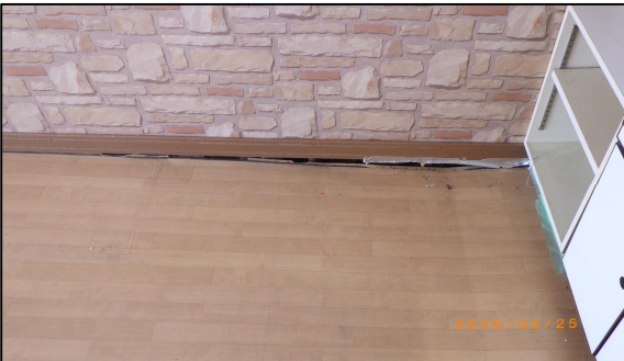
建物内部 ※床落ち部分
