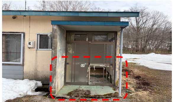
建物外部図面左（玄関戸） ※ガラス一部、土間一部破損
