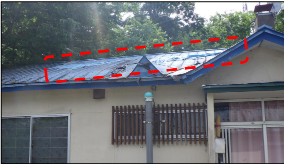
建物外観 ※屋根損傷部分
