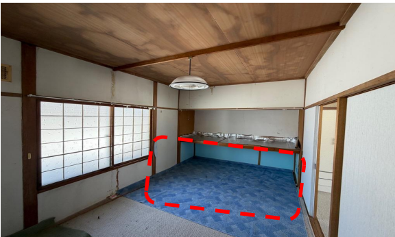
建物内部（和室2）※床一部沈み込み有
