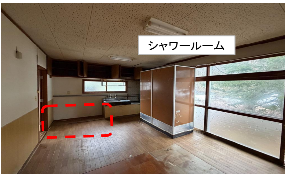
建物内部（リビング） ※床落ち一部有リ
