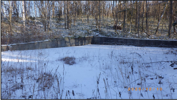
コンクリート工作物（土留め）
