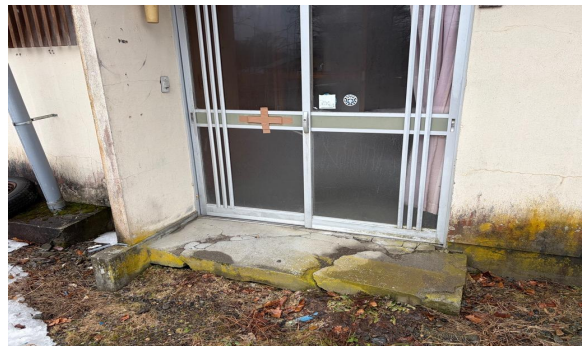
玄関ポーチ ※土間部分損傷
