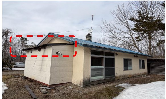
建物外観 ※屋根損傷部分
