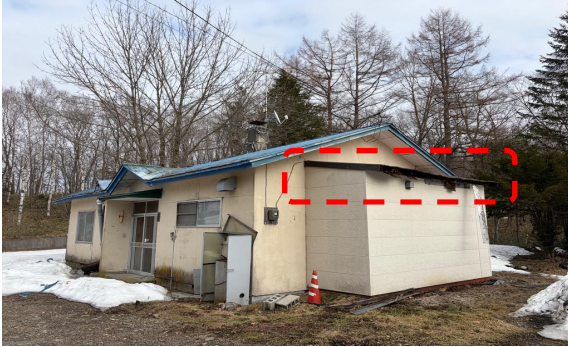
建物外観 ※屋根損傷部分
