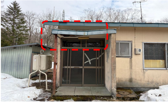
建物外部 図面右（玄関戸） ※屋根損傷部分有
