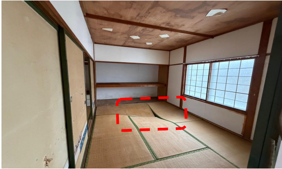
建物内部（和室2） ※床落ち有（全体的に床歪み有）
