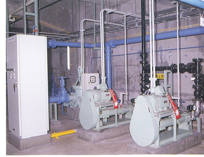
▼汚泥移送ポンプ
