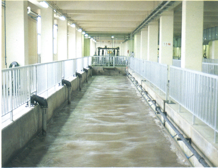
▼エアレーションタンク
