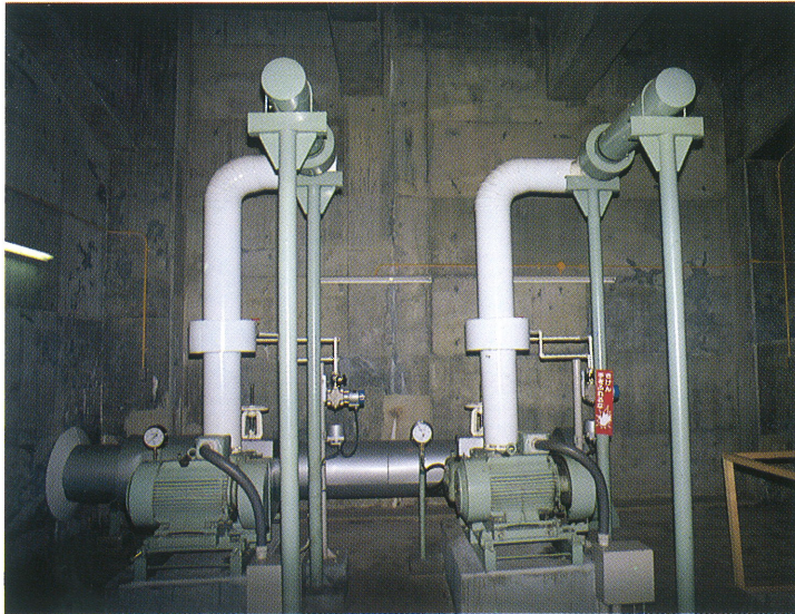
▼曝気ブロー室
