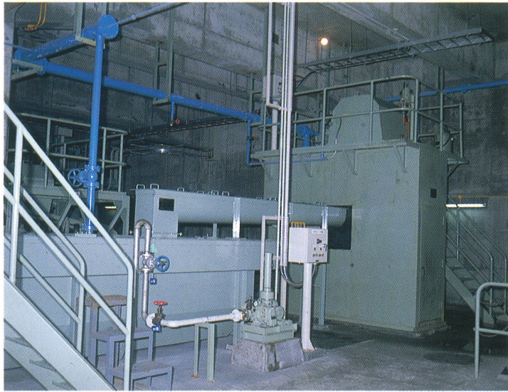
▼沈砂池(沈砂掻上機)
