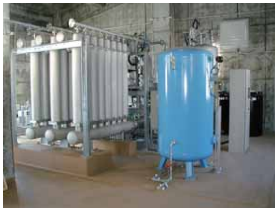
開陽浄水場膜ろ過装置
