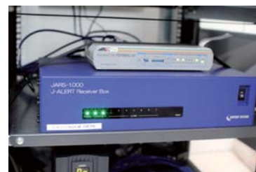
庁舎2階総務課に設置された Jアラート受信システム
