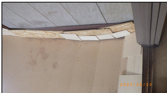
建物内部（1番1の2） ※床落ち
