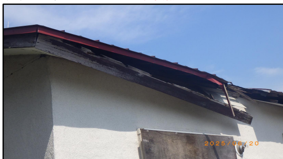
建物（1番1の1） ※屋根損傷
