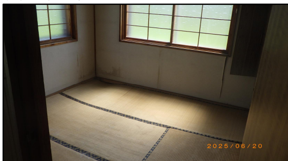
建物内部（1番1の2） ※床落ち
