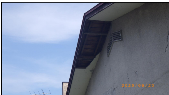
建物（1番1の1） ※屋根損傷
